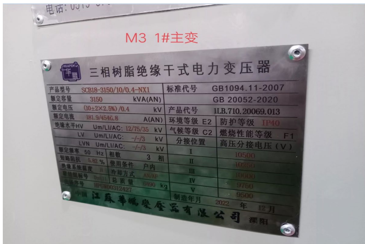
厂区分变名牌照片（1级，已完成整改）
