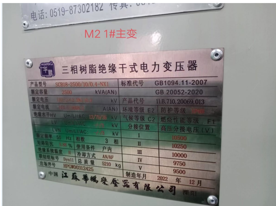
厂区分变名牌照片（1级，已完成整改）
