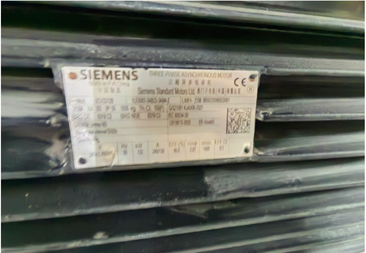
冷却水泵电机名牌照片（1级，已完成整改）
