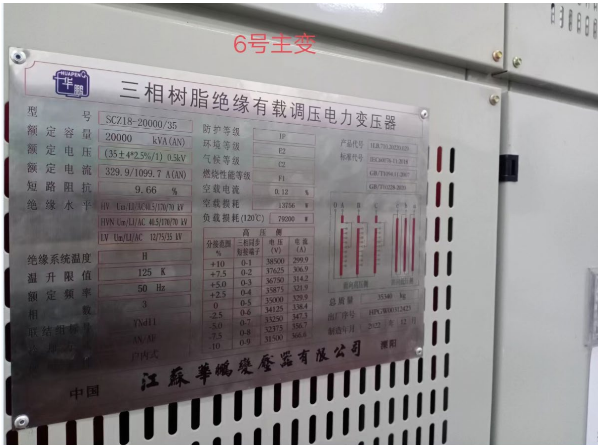
厂区主变名牌照片（1级，已完成整改）
